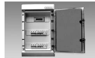
Szafka zasilająco-sterująca pompowni dwupompowej
