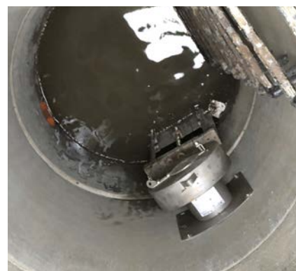
DAS Praha – retenční nádrž s vírovým ventilem
