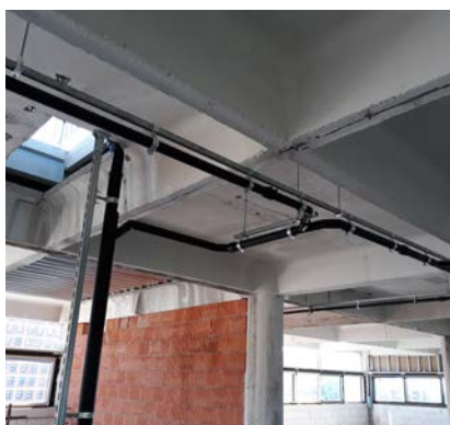
Prior Zlín – rozvody potrubí a napojení na stoupačku
