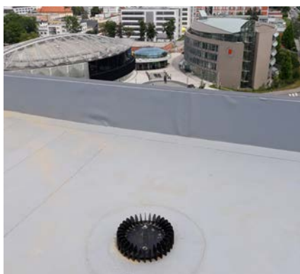
Prior Zlín – osazený střešní vtok QSM75 ve střeše
