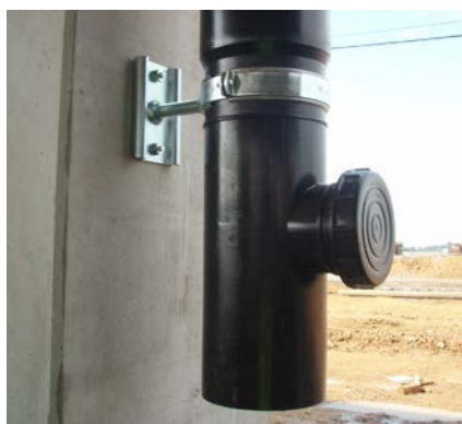
Hyundai Motor Manufacturing Czech Nošovice – čistící kus a kompenzační hrdlo na svislém svodu
