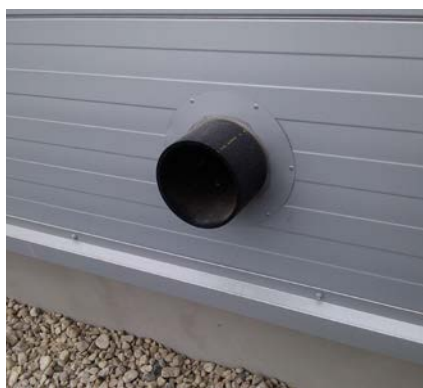
Škoda H1 Mladá Boleslav – vyústění bezpečnostního systému skrz fasádu
