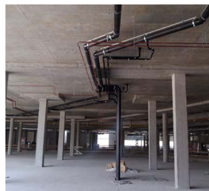
Central Kladno – rozvody potrubí a stoupačky odvodnění
