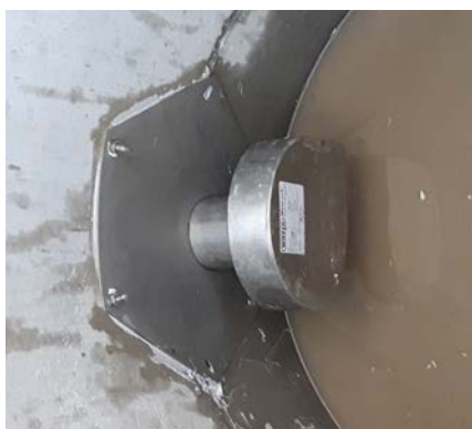
Brno Slatina Řípská – vírový ventil CEV 250
