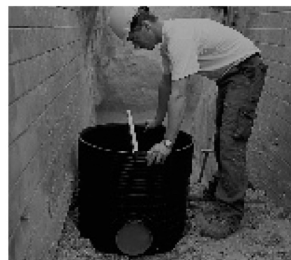
1 Brunnsbotten placeras på en stenfri ledningsbädd. Det är inte inbyggt fall i brunnen.
