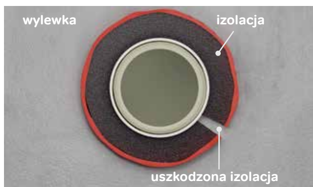
Rys 40: Przenoszenie dźwięku materiałowego i straty ciepła na skutek uszkodzonej izolacji rury.
