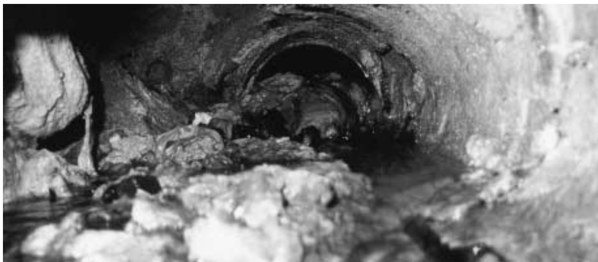
Figur 9 - Mange tærede og nedbrudte kloakledninger skal udskiftes i de kommende år
