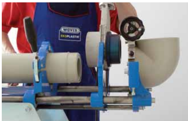
átállítás hevítés után
