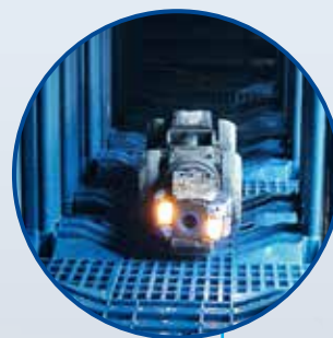
Kamera CCTV w zbiorniku
