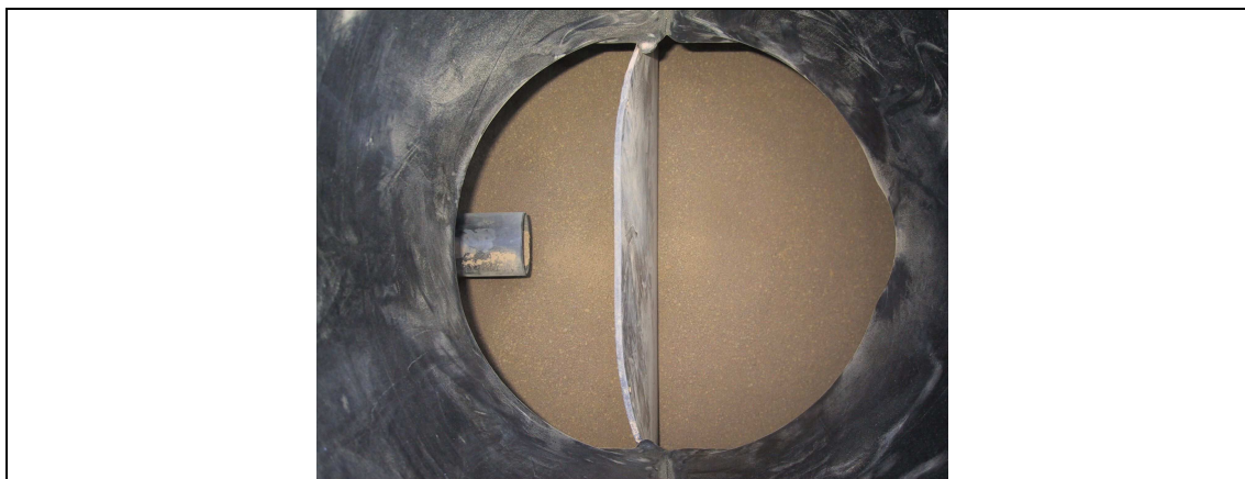
Bild 3. Filter jämnt fyllt med avfosforiseringsmassa.
