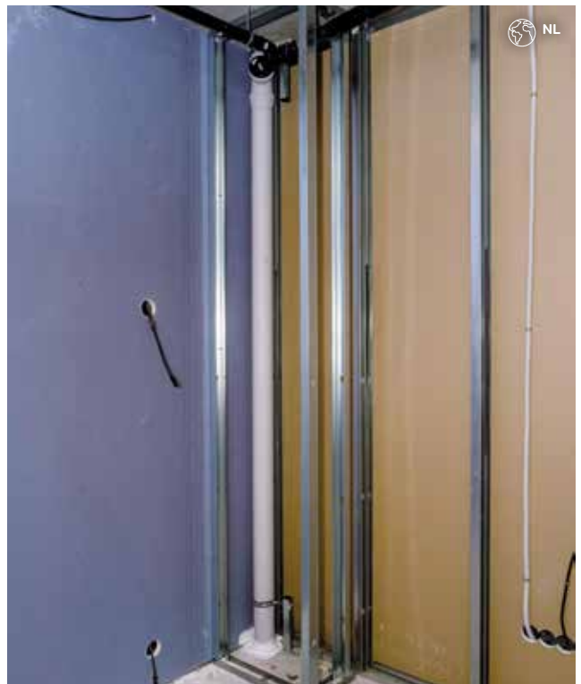
Kuva 12: Putken ääntä eristävä kannakointi kattoon ja lattiaan kevyen väliseinän vieressä
