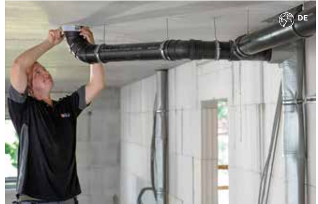
Kuva 39: Putkieristeellä eristetty viemäriputki
