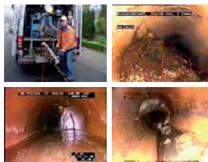
Rysunek 2a, b, c, d Sprzęt do inspekcji TV i przykłady problemów pojawiających się w istniejących rurociągach
