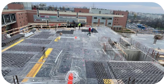
Betonové vývodky se spojovacími trubkami topného potrubí vedenými v ochranné trubce
