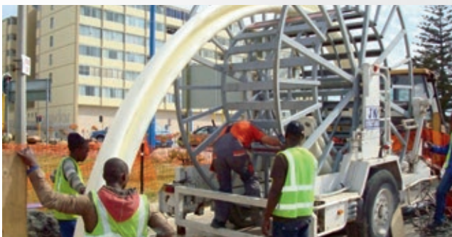
Afrique du Sud, Durban, DN250, eaux usées
