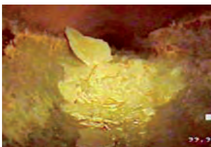
typowy stan starego rurociągu gazowego
